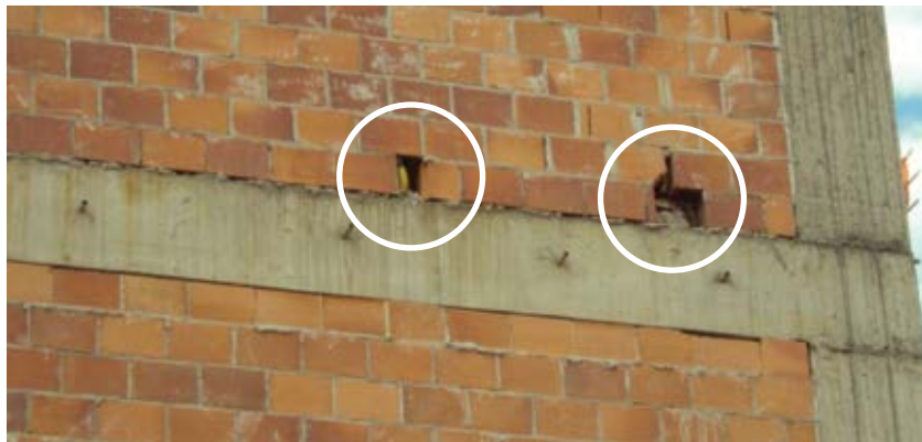
Depressões decorrentes da quebra parcial dos blocos devem ser preenchidas.
